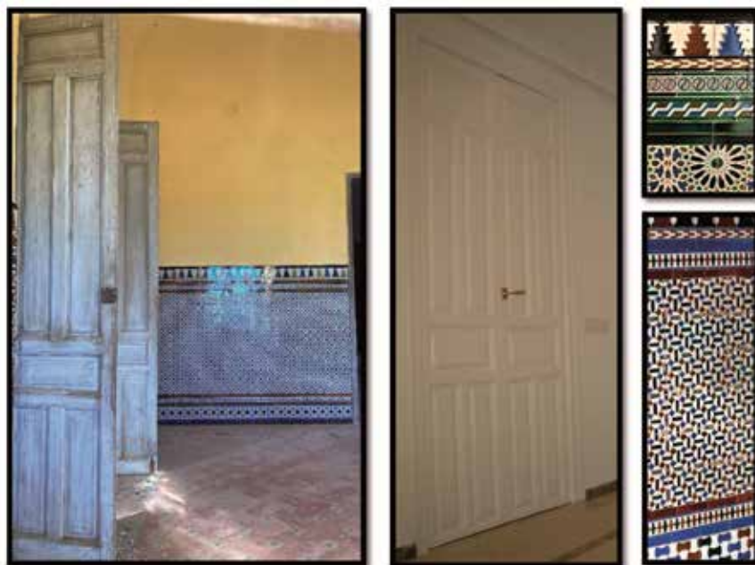
Fig. 879 a 882. Similitud entre las puertas y el zócalo de azulejería en "La Poyatas", puerta en su vivienda particular en Santa Lucía, 4 ( observe el espacio reservado al pomo, idéntico también) y zócalo de azulejería en la catedral de Badajoz y en otros inmuebles levantados por el arquitecto. Fuente: imágenes de elaboración propia. Nota: La solería pertenece a una reforma posterior realizada por el arquitecto Luis Morcillo, que a su vez era discípulo de Francisco Vaca y era la típica que él utilizaba para los cortijos (consultar bocetos en el libro 3.)
