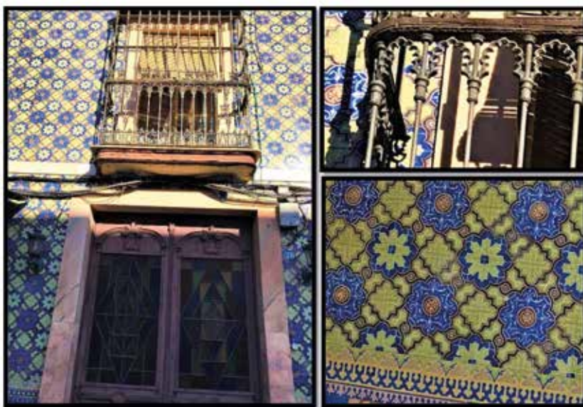
Fig. 201 a 203. Vivienda en la calle Joaquín Costa, 26, detalle de los azulejos en la fachada y rejería con arcos polilobulados. Fuente: elaboración propia.
