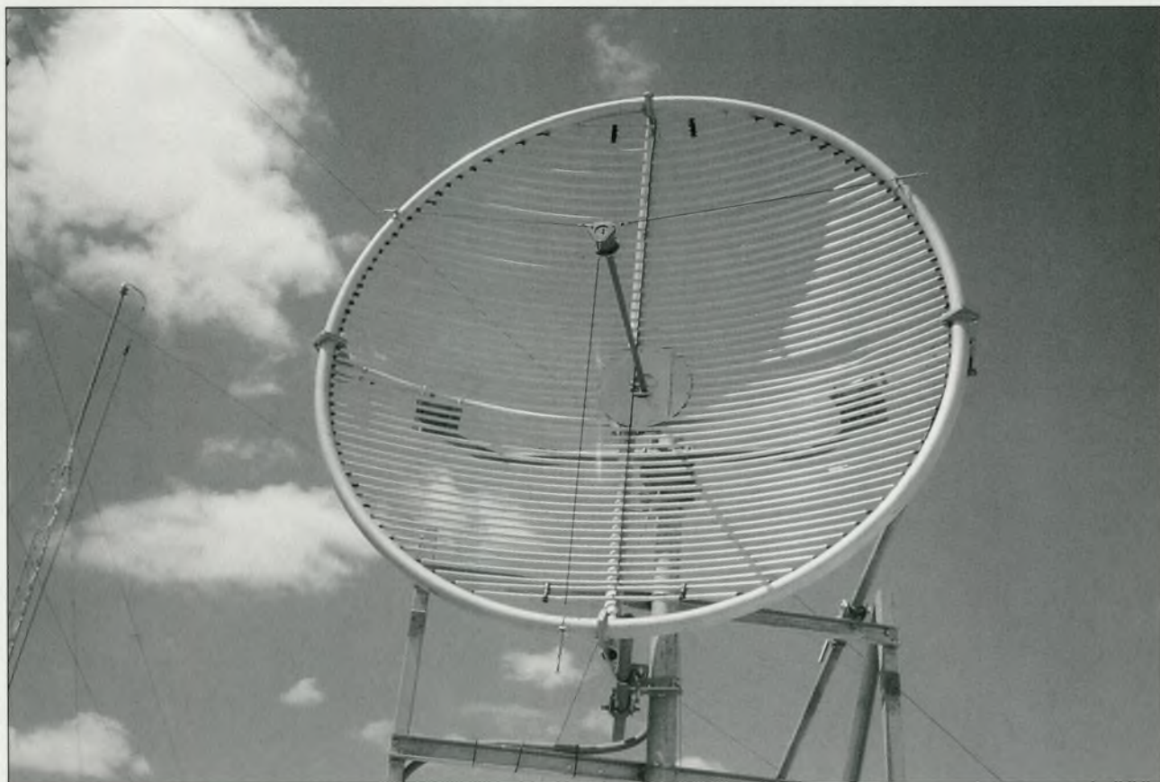
Antena parabólica receptora de la transmisión de señal vía microondas.
